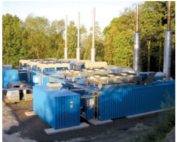
Anlage, die aus Grubengas ca. 6 MW elektrische Leistung erzeugt – genug, um ca. 12.000 Haushalte mit Strom zu versorgen Foto: OFM Operation & Facility Management GmbH
